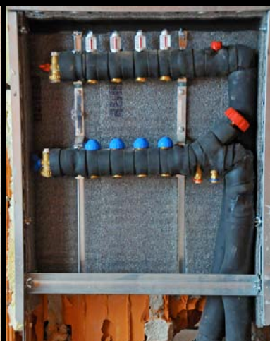
Izolacija cevi (toplotna i zvučna zaštita)
