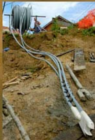
5 vertikalnih geotermalnih sondi koje idu 100m u zemlju
