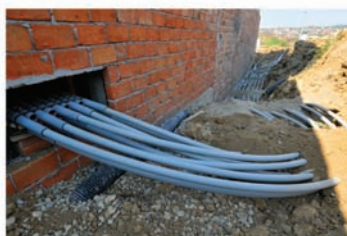
Prolaz za 5 sondi unutar Amadea za konekciju sa toplotnom pumpom. Passage of the 5 probes inside Amadeo for the connection to the heat pump.
